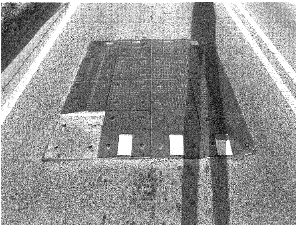
Zdjęcie nr 3. Brak jednego elementu w spawalniczu.
