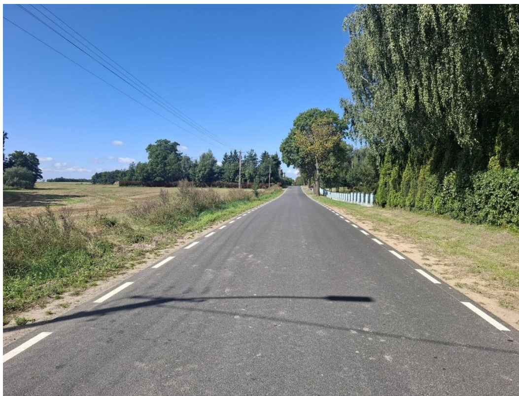
Fot. nr 17 Przebudowa dróg powiatowych nr 1244C Dąbrówka – Biechowo oraz 1246C Plewno – Belno, źródło: własne
