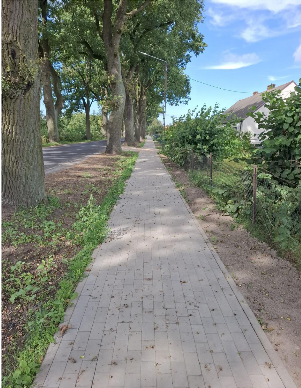
Fot. nr 37 Budowa chodnika przy drodze powiatowej nr 1049C w Łowinku, źródło: własne
