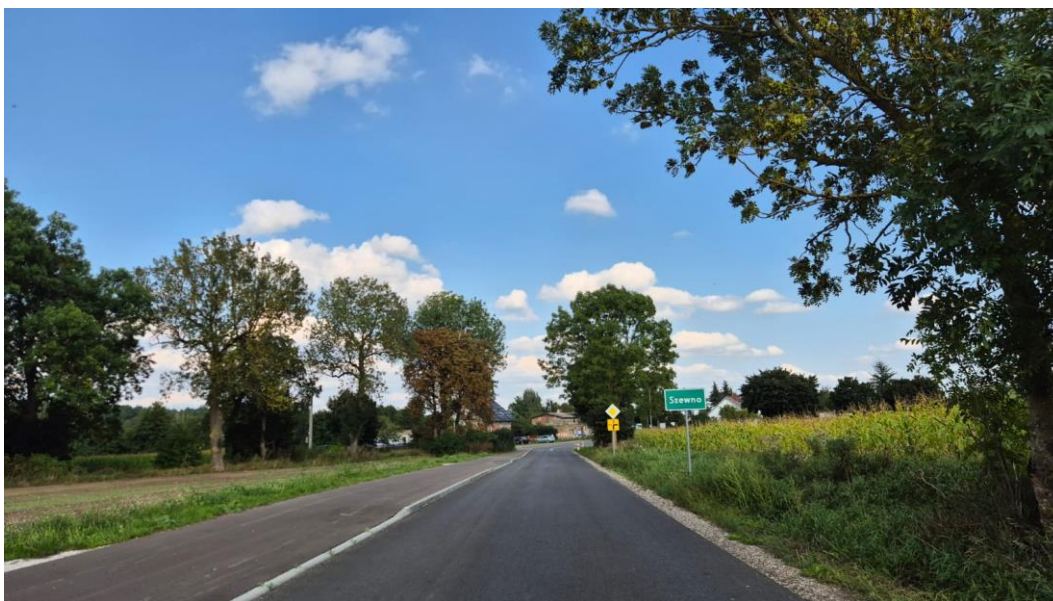
Fot. nr 28 Remont odcinka drogi powiatowej nr 1263C Świekatowo – Bukowiec, źródło: własne
